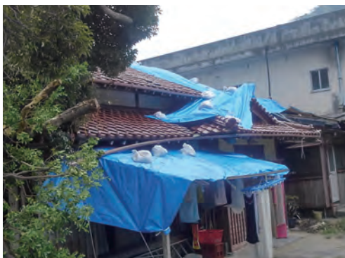
ブルーシートで補修された家屋が多数
